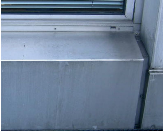
Zustand vor der Reinigung
