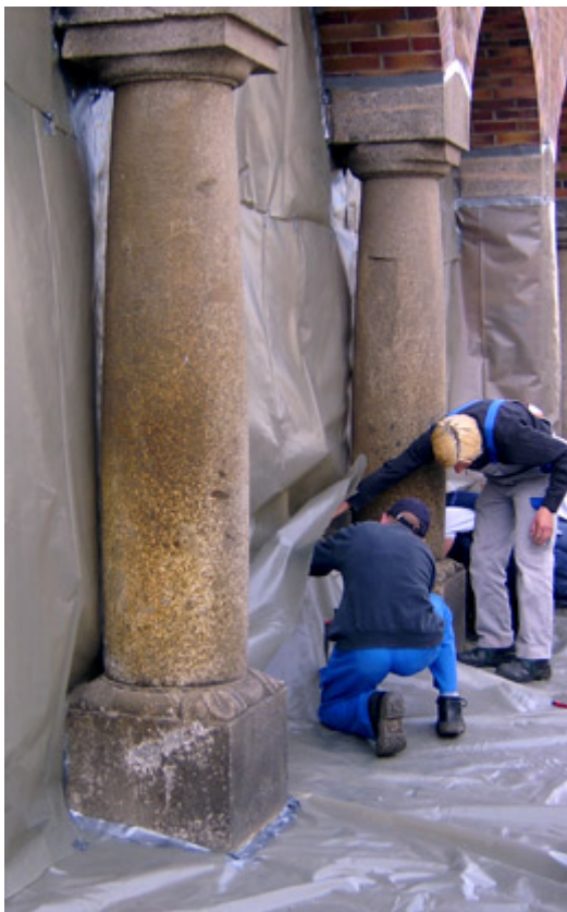
Granitsäulen vor der Reinigung
